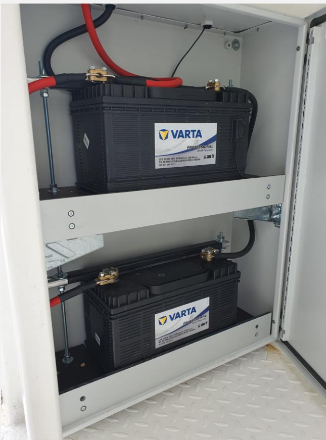
Batterijen om de container van stroom te voorzien
