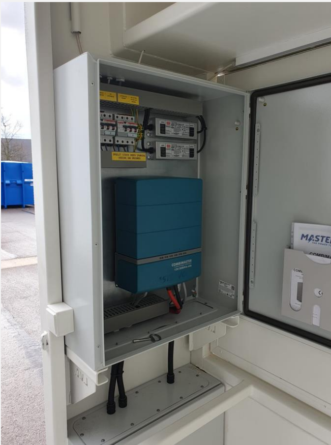
Elektrische schakelkast met batterijlader en LED drivers
